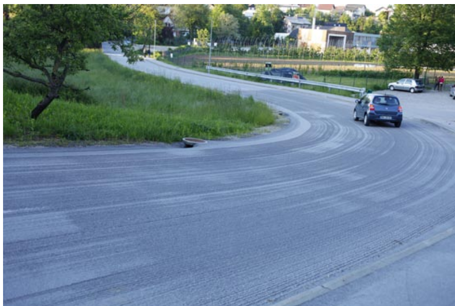
Neprimerna podlaga na Smrečnikovi ulici, nastroženo cestišče.
