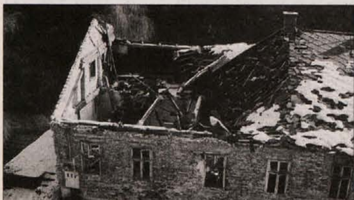
KOT BI TREŠČILA BOMBA - Tako klavno podoba daje Flekov mlin v starem črnomaljskem mestnem jedru, odkar se je zaradi dotrajanosti streha pod težo snega in let zrušila. Črnomaljši si že dolgo želijo, da bi se končno kdo spopadel s to mestno sramoto. Kot je zagotovil direktor občinske uprave Božidar Brajkovič, naj bi se to v resnici kmalu zgodilo. (Foto: M. B.-J.)
