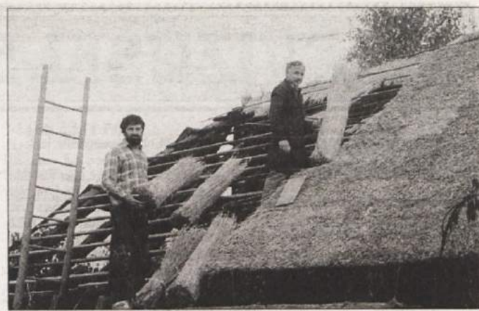
NA SLAMNATI STREHI - Ivanu Pezdircu (z brado) in krovcu Zvonku Operčkalu je uspelo v dveh tednih prekriti z rženo slamo streho, ki velja za eno največjih slamnatih streh v Beli krajini. Za lastnika pa je najpomembnejše, da bo v stari belokranjski leseni hiši teklo življenje, morda pa bo prišla prav, da bodo v njej obujali tudi stare običaje. (Foto: M. B.-J.)
