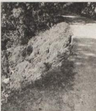
PLAZ NAD SEMIČEM - Po cesti nad zemeljskim plazom (na sliki) se ljudje vsak dan vozijo z avtomobili v službo, v času trgatve pa so pogosti tudi traktorji. Nevarnosti za zdaj menda ni. (Foto: L. M.)
