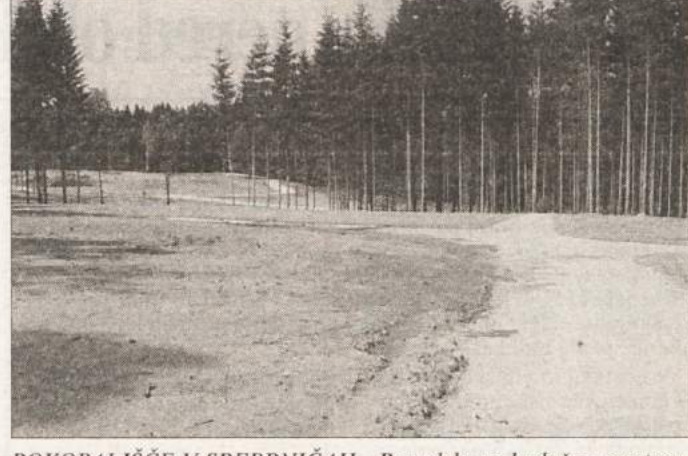
POKOPALIŠČE V SREBRNIČAH - Prva dela na bodočem mestnem pokopališču v Srebrničah so že opravljena, avgusta pa naj bi z deli nadaljevali in naslednje leto oktobra naj bi že bili možni prvi pokopi. Do prijetnega parkovnega pokopališča bodo od Drske do Srebrnič naredili tudi pločnik. (Foto: J. D.)
