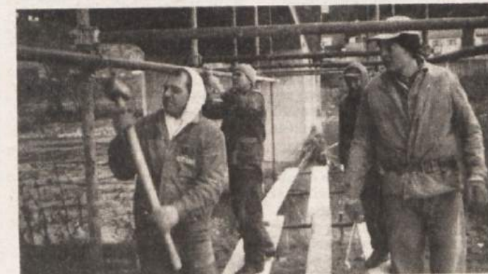
OBNAVLJAJO MOST - Most čez Savo v Krškem bo ljubljansko gradbeno podjetje Gradis temeljito obnovilo. Zamenjalo bo celotno gornjo površino in povsem obnovilo spodnji del mostne konstrukcije in s tem ohranilo obstoječo nosilnost precej obremenjenega in v zadnjem času jamastega cestnega objekta. Most bo med popravilom prevozen, ker bosta ves čas odprti za promet dve tretjini vozišča. Po besedah Darka Pangerca iz Gradisa bodo most, pri katerem v teh dneh urejajo gradbišče, prenovili predvidoma do septembra. (Foto: L. M.)
