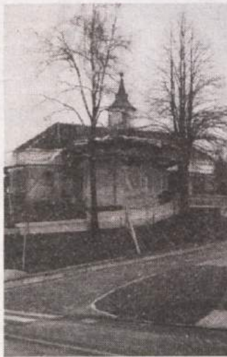
KONČNO OBNOVA - Metličani so si oddahnili, ko so gradbinci okrog Martinove cerkve postavili zidarske odre in jo začeli obnavljati. Grozilo ji je namreč že, da se bo porušila. (Foto: M. B.-J.)
