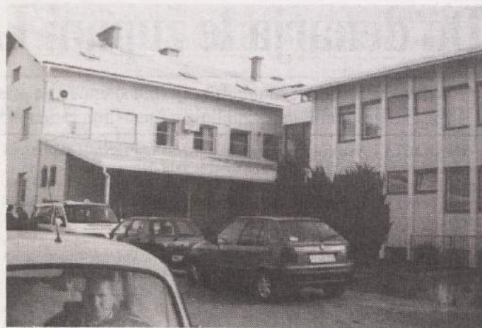
LEPŠA PODOBA - V metliškem zdravstvenem domu že vso jesen potekajo obnovitvena dela, ki naj bi bila končana do konca leta. Tako so prekrili streho, zamenjali zlebove in ograje na balkonih, prebelili fasado ter uredili vhod, da bo zdravstveni dom dostopnejši za invalide. Obnova je bila že nujno potrebna, saj zadnji dve desetletji v zdravstvenem domu ni bilo večje naložbe. Obnova bo veljala 8 milijonov tolarjev, največ denarja pa so zbrali v zdravstvenem domu sami. (Foto: M. B.-J.)
