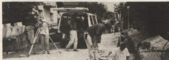
KOPANJE JARKOV V LOBETOVU - No, pa se je začelo tudi na tej strani mesta! V Lobetovu ulici kopljejo jarke čez hrib proti Cikavi, polagajo cevi za plin in kabel za kabelsko televizijo. Delajo tudi v ulici Pot na Gorjance. Seveda je promet oviran, tudi hrupno je, vendar je glavno, da se dela! Foto: Z. K)
