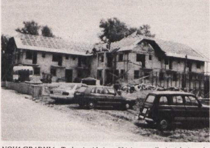
NOVA GRADNJA - To, kar je videti na sliki, je na podlagi priglasitve obnovitvenih del zraslo v slabih šestih tednih. Inšpektor zahteva odstranitev črne gradnje do srede septembra. (Foto: A. B.)
