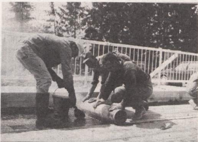
NOVI MOST V DOLENJI STARI VASI - Gradnja novega mostu, regulacija okrog 800 m struge Lucega potoka, širitev ceste iz vasi proti mostu, ureditev okolice in postavitve javne razsvetljave v Dolenji Stari vasi bo stala okrog 40 milijonov tolarjev. Dela na mostu gredo počasi h kraju, na sliki pa so delavci novomeške VGP-ja, ki so konec prejšnjega tedna na mostu polagali izolacijo. (Foto: J. Dorniž)
