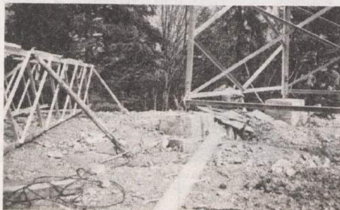
POSTAVLJAJO PRETVORNIK - Na Kostrevcu, hribu nad Osilnico, postavljajo te dni stolp za televizijski pretvornik, da bodo Konečno vsi prebivalci osilniške občine lahko gledali prvi in drugi program slovenske televizije. Pri postavljanju pa je prišlo do manjše nevarnosti, saj žerjav ni mogel dvigniti dovolj visoko najvišjega dela stolpa. Dela bodo kljub temu končana do 1. maja, ko bodo za občinski praznik uadno odprli pretvornik, pri katerem bodo tudi druge potrebne naprave za potrebe sprejemanja radijskih programov in delovanje mobitela. (Foto: J. Prime)
