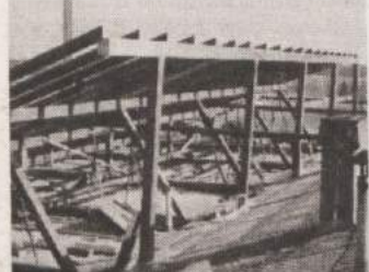
NOVA STREHA NA ŠOLI - Na prizidku pri osnovni šoli Dragatuš, ki je bil narejen leta 1982, a so imeli zaradi ravne strehe vedno težave, črnomaljski Beograd postavila novo streho. S pripravljanimi deli je začel že lani, zaradi slabega vremena pa naj bi streho dokončali predvidoma maja. Dela bodo po oceni veljala 9 do 10 milijonov tolarjev. (Foto: M. B.-J.)
