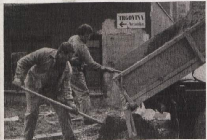
DELAVCI NOVOGRADA ZADELALI LUKNJO - V blokovskem naselju Plava laguna je bila ob cesti v neposredni bližini kurilnice že nekaj časa globoka luknja, ki je ogrožala varnost ljudi, predvsem otrok. Pred kratkim jo je nekdo pokrival z železom, prejšnji petek pa so jo z betonom zadelali delavci novomeškega Novograda. Globoko luknjo naj bi naredile meteorne vode, zanimivo pa je, da se je pojavila pred kratkim, po tistem, ko so lani napeljevali plinovod. (Foto: J. Dornič)
