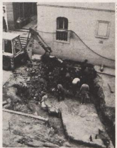
Temelji mestnega obzidja med izkopavanjem. Vhod na fasadi Obrezove hiše kaže na nekdanji nivo vhoda v mesto.
