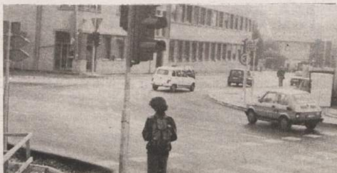
KRIZIŠČE NARED, KAJ PA CESTE? — Tri dni pred rokom je GIP Pionir uredil novomeško križišče pri Ljubljanski banki in Tilii do te mere, da je bila prvi dan novega šolskega leta otrokom zagotovljena kar se da varna pot v šolo. Nadaljuje tudi s postavljanjem semaforjev in druge signalizacije, zatem naj bi uredil še trg med LB in Tilii itd. Kako hitro se bo vse manjkajoče odvijalo, je še vprašanje, saj je od pogodbenih 72 milijonov tolarjev za ta dela izvajalec dobil zaenkrat le 8 milijonov. Rekonstrukcija Ceste herojev mimo šol do križišča s Koštialovo pa se je že odmaknila najmanj v naslednje poletje. Tudi obupno luknjasti makadam na Cesti komandanta Staneta mimo gradbišča blagovnice bo po napovedih vsaj še nekaj mesecev jezil voznike. Zasilno asfaltiranje bi bilo predrago, za ta pravo pa vseh zadev še nimajo urejenih. (Foto: J. Pavlin, tekst: Z. L.-D.)
