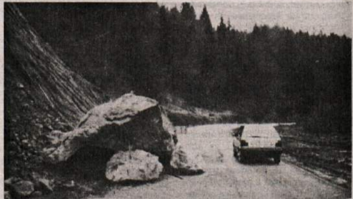
SKALA NA CESTI — Ob zadnjem večjem deževju je prišlo na območju KS Osilnici in drugod do premikanja tal in plazov. Na medrepubliško cesto pri Osilnici pa je zdrsnila tale skala in zaprla promet po enem voznem pasu. Minuli teden so skalo navrtali, da jo bodo ta teden razstrelili, saj je tako velika in težka, da je drugače ni možno spraviti s ceste. (Foto: Primc)
