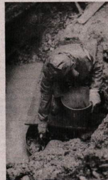
ČIŠČENJE NAFTE — Da bi ublažili posledice in preprečili nadaljnje nevarno iztekanje nafte v Tržišnico si prizadevajo vsi — od delavcev Hidrotehne do teritorialcev. Družno skušajo najti čimhitrejšo rešitev. (Foto: M. L.—S.)
