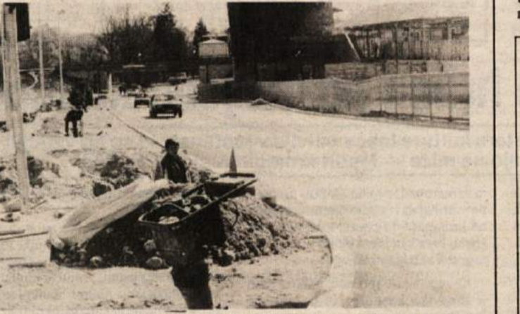
KDAJ BO SPREJELA PRVE AVTOBUSE? — Odgovora na to vprašanje ne ve nihče v Novem mestu. Ta čas, ko Pionirjevi delavci popravljajo to in ono — na posnetku so med urejanjem dostopne ceste minuli petek — si drugi — glavno, kako to črno gradnjo narediti manj črno. Može je Ljubljane, ki so bili prisotni pri ponosrečenem poskusu tehničnega pregleda, kar niso mogli verjeti, da je mogoče toliko napak, nepravilnosti in nezakonitosti najti na enem kupu. (Foto: B. Budja)
