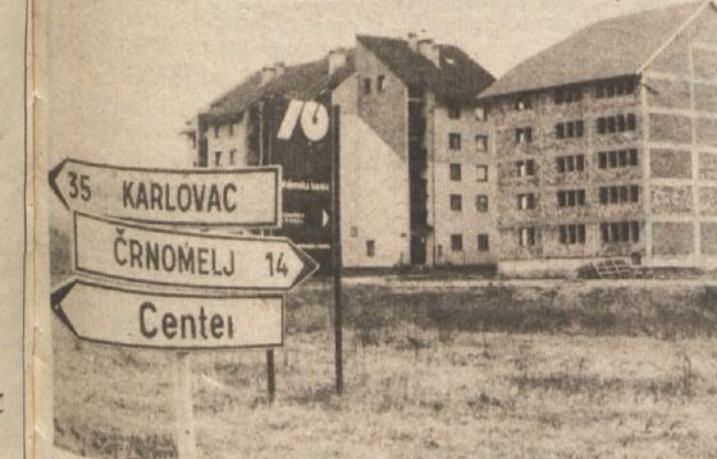
NOVA STANOVANJA V METLIKI — Novomeški Pionir gradi v Kidričevem naselju v Metliki nov stanovanjski blok. Pravzaprav gre za gradnjo prve faze bloka in v tej polovici bo 22 stanovanj. Stanovanjska skupnost je kupila 12 solidarnostnih stanovanj, nekaj so jih kupile delovne organizacije, štiri stanovanja pa so se naprodaj. Blok so začeli graditi lani poleti, zgrajen pa naj bi bil novembra, pred letošnjim občinskim praznikom. (Foto: A. B.)
