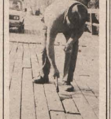
SIZIFOV POSEL — Martin Gramc se vsako jutro loti popravila mosta. Toda z nekaj deskami in žebji ni mogoče odpraviti poškodb, ki nastanejo čez dan.
