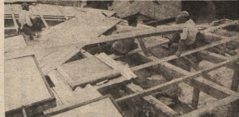
Del strehe na bloku v Ulici 1. maja je odpihnil, dež, ki je spremljal neurje in padal tudi naslednji dan, pa je naredil veliko škodo v podstrešnih stanovanjih.
