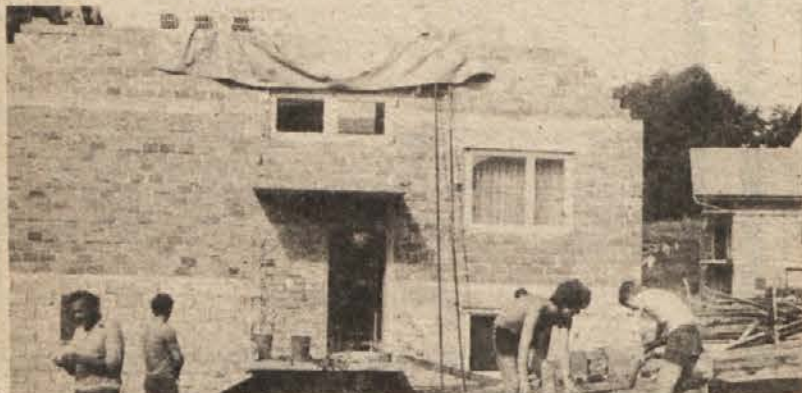
S Cvetkovičeve hiše v metliškem Naselju Staneta Rozmana je orkanski piš odnesel celotno streho, hudo pa je poškodoval tudi sosednjo Slobodnikovo hišo.
