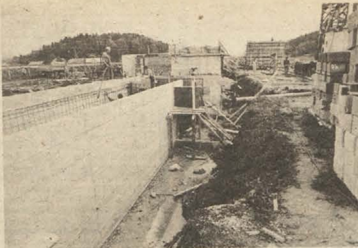
ČISTILNA NAPRAVA DO ROKA - Pionirjevi delavci so začeli graditi trebanjsko čistilno napravo sredi julija. Če bo graditeljem naklonjeno tudi vreme, jo bodo dokončali do konca tega leta.
