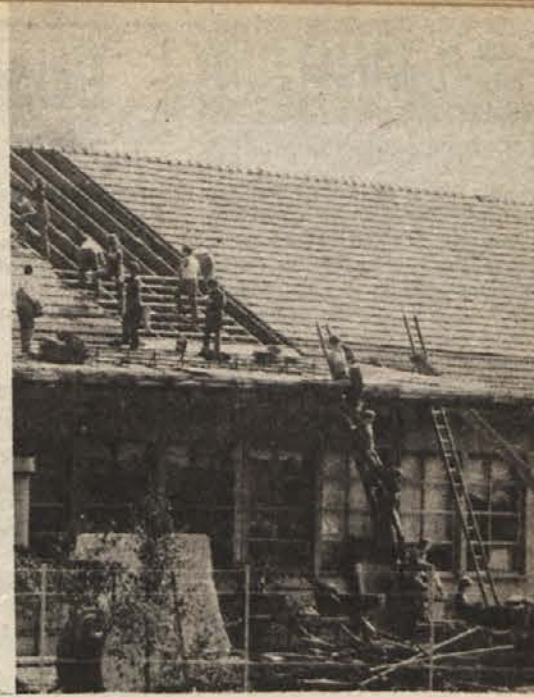
SAMI SVOJI KROVCI — V sevniškem stilisu so se odločili, da sami prekrijejo streho proizvodne dvorane. Dela so se po skupinah lotili vsi, od mizarjev do pisarniških delavcev. Kolektivni duh, s pomočjo katerega je ta tovarna zrastle, torej še živi (Foto: A. Železnik)
