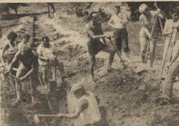
UDARNIŠKI DUH ŠE ŽIVI — Krajani starega dela Sevnice in še nekaterih drugih ulic, ki predzadnje soboto niso utegnili na zasipavanje cevi za vodovod izpod Lisce, so se izkazali v nedeljo, 2. avgusta. Z ramo ob rami je s stotnjico vojakov delalo 90 krajanov, med njimi je bilo kar 40 mladih iz vrst taborniškega odreda Treh smrek. Od začetka julija, ko so se akcije začele, je bila to najbolj številna skupina krajanov. (Foto: A. Zeleznik)
