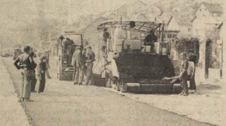
PRVI METRI ASFALTA — Na ločenski strani Ceste herojev so delavci Cestnega podjetja že prejšnji teden začeli polagati asfalt. To je najboljši znak, da gre rekonstrukcija ceste vendarle h koncu in da se bo promet spet normaliziral. (Foto: R. Bačer)
