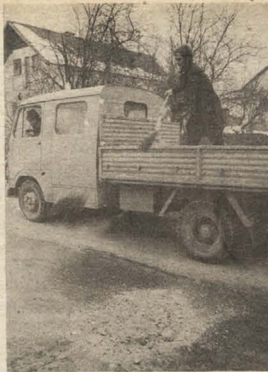
ASFALT SPREMINJA PODOBO — Dolga in mrzla zima je letos doobara preluknjala dolenjske asfaltne poti. Globoke udarne jame so za voznike in za vozila hudo nevarne, zato jih delavci Cestnega podjetja zasipavajo s peskom. Tudi v nedeljo (na sliki) dela dežurna ekipa. (Foto: J. Pavlin)
