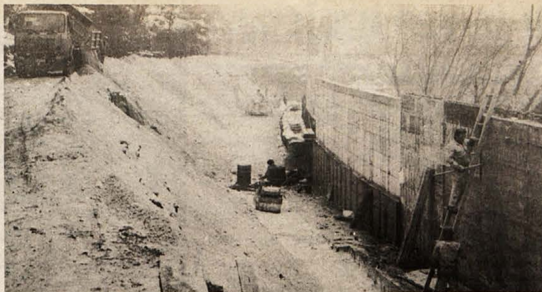
NEPREDVIDENE TEŽAVE — Pri gradnji Ceste herojev so naleteli na slabšo nosilnost tal, kot je bila predvidena, zato so morali na najglobljem mestu podaljšati oporni zid za 11 metrov. Doslej je gradnja že za 10 milijonov dinarjev dražja, vrh vsega pa izvajalcem del močno nagaja še vreme. (Foto: Janez Pavlin)
