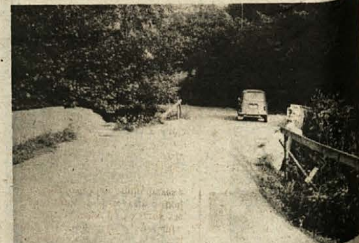
KAMERA ODKRIVA – Republiška skupnost je bila že pred meseci obveščena, da je most pod Migolico, na cesti med Mirno in Gabrovko, močno poškodovan. Od tedaj ni bilo do danes na tem mostu nič narejenega. Postavljene so samo nekakšne zaščitne planke, ki ne bi zdržale niti kolesarja. Verjetno bo treba popravilo počakati do tedaj, ko se bo z mosta zvalil prvi avtomobilist. (Foto: Jože Simčič)
