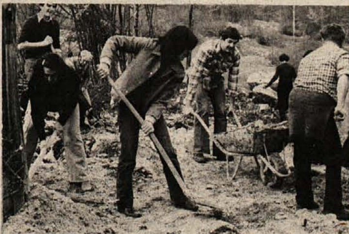
HORUK ZA BOLJŠI JUTRI — Zadnjo soboto so ponovno oživela Novogradova delovišča. Zaključnih del so se s prostovoljnim delom lotili prav vsi. Največ se jih je potilo v Zagradcu (na sliki). (Foto: J. Pavlin)
