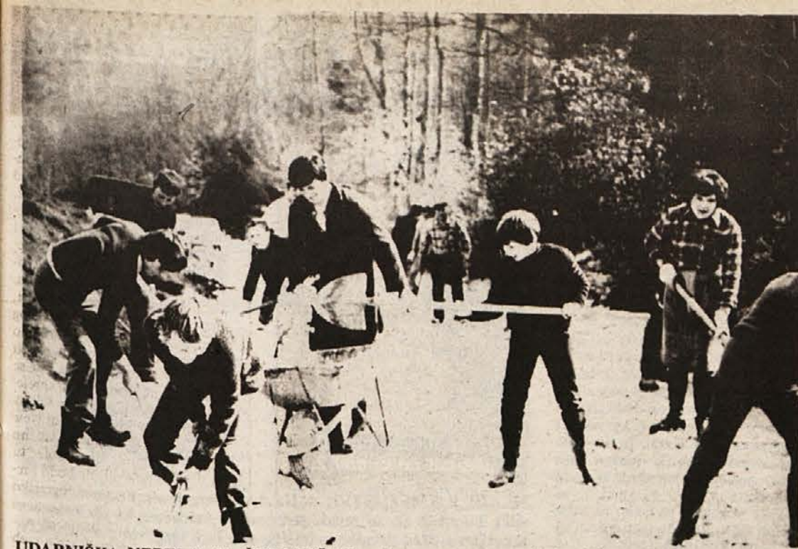
UDARNIŠKA NEDELJA V ŠKRJANČAH — Pretežno s prostovoljnimi delom in lastnimi sredstvi se lotevajo posodobitve 1860 metrov dolge vaške ceste od Škrjanč do Boričevega krajani pod okriljem krajevne skupnosti Šmihel. Zadnje nedeljo je 25 vaščanov delalo na cesti. Doslej je bilo opravljenih že preko 300 prostovoljnih ur, še dvakrat toliko dela pa jih čaka poleg 12.000 din prispevka, kolikor je dala vsaka hiša, preden bo cesta asfaltirana. Pa še bo manjkalo... Trdno računajo na pomoč komunalne skupnosti, saj so krajani Boričevega maloštevilni, pa so kljub temu dali velik prispevek za cesto. (Foto: Bačer)
