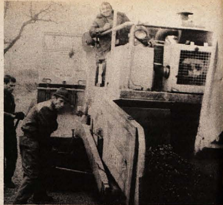
ASFALT DO ČRNEGA POTOKA — Minuli teden so asfaltirali nad dva km dolg cestni odsek od magistralne ceste preko Zajčjega polja do Črnega potoka pri Kočevju. Cesta je široka 4 m, na njej pa je 10 cm asfalta. Delo je opravila ekipa Slovenija ceste. (Foto: Primc)
