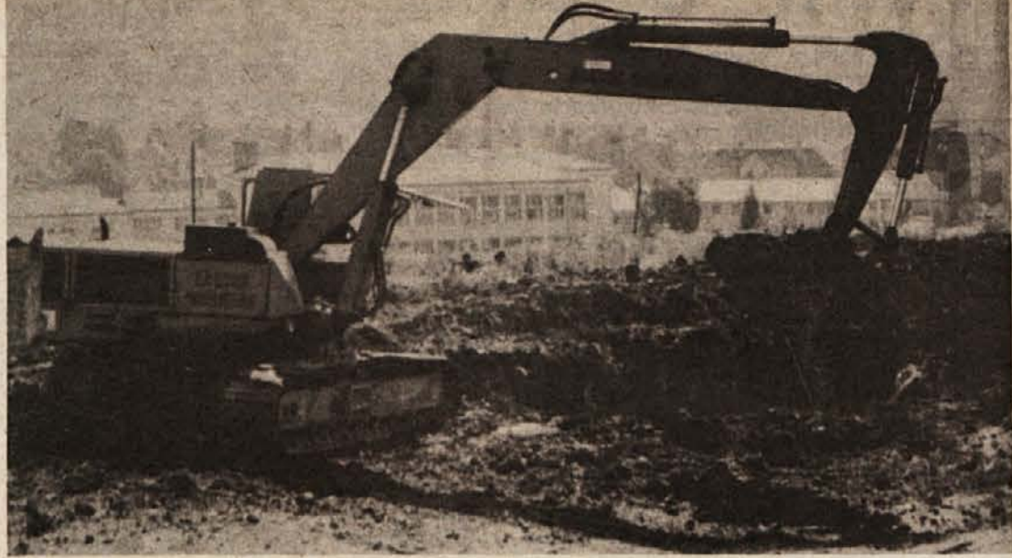
GRADNJA SE JE PRIČELA — Težko pričakovana gradnja nove osnovne šole v Trebnjem se je te dni pričela. Gradbinci za zdaj pripravljajo teren in kopljejo temelje za bodočo šolo. Računajo, da bodo zemeljska dela končana do konca oktobra. Potem se bo pričela prava gradnja, ki naj bi bila končana do julija 1981. (Foto: J. Simčič)
