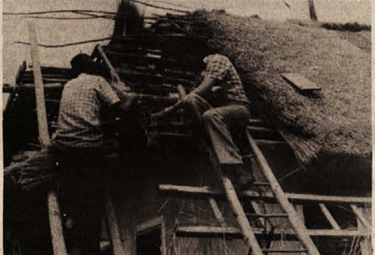
ENA OD REDKIH — Nekdaj je bila večina hiš v Beli krajini kritih s slamnato streho, danes pa se le izjemno primeri, da želi kdo imeti takšno streho nad glavo. Jančarjevi iz Kašče pri Semiču so obnovili staro slamnato streho, a so imeli težave, saj so komaj dobili dovolj slame, po krovca, še večjega tega opravila, pa so morali v Suho krajino. (Foto: F. Derganc)
