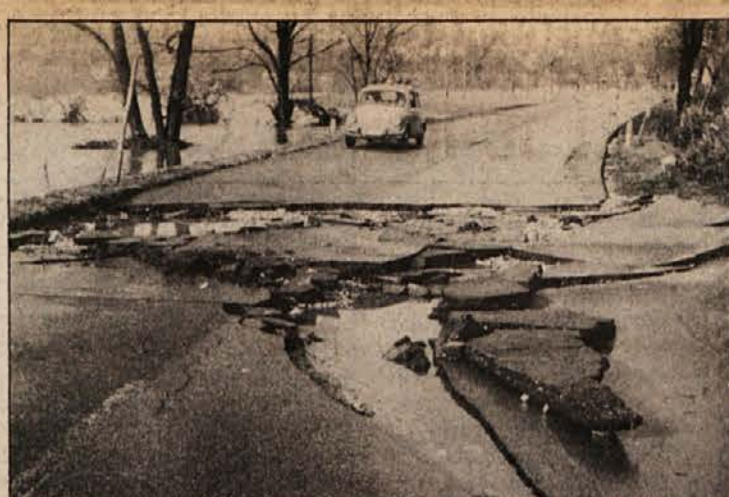
CESTNE RANE — Stevlinum cestnim ranam, ki jim je menda kriv samo kanček odstopka parafina več v sicer odličnem jugoslovanskem asfaltu, so se pridružile še razpoke ob povodnjih. „ko so se vode umaknile“, je bilo razdejanje na magistralni cesti pri Sevnici videti nekako takole. (Foto: A. Železnik)
