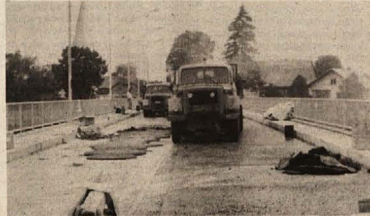
TIK PRED KONCEM — Cestišče novega mostu čez Krko v Krški vasi prelivajo z asfaltom. Do sobote, 16. septembra, bo vse nared. Most bodo tedaj slovesno odprli. Povezava obeh bregov Krke je bila nujna, saj stari leseni most ni več mogel vzdržati naraščajočega prometa. (Foto: Jožica Teppey)
