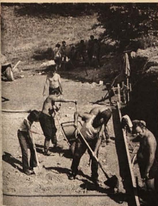
ZAČELI SO DOBRO – Lovci iz Orehovice pri Šentjerneju so v nedeljo, 6. avgusta, zabetonirali temelje svoje nove lovske kočice blizu Miklavža na Gorjancih. Temeljni kamen je že dan poprej položil starosta orehovskih lovcev Franc Luka. (Foto: Polde Miklič)
