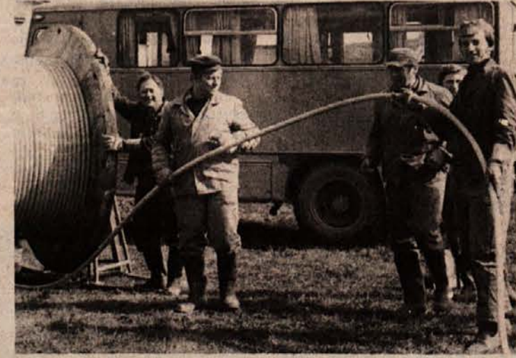
VISOKONAPETOSTNI KABEL — Napeljujejo ga do bodočega transformatorja pri Agrotehnik. Temu delu mesta se končno le obeta boljše luč ob večerih in manj okvar na gospodinskih aparatih. (Foto: J. Teppey)
