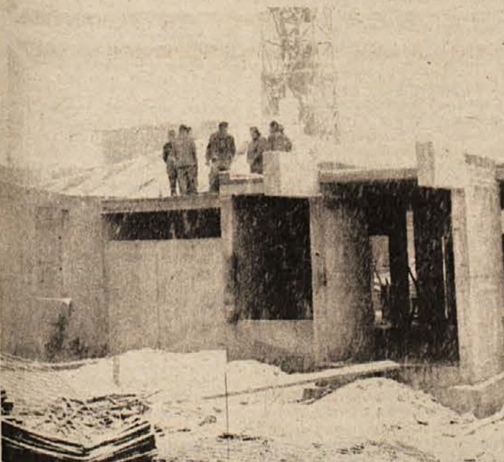
VRTEC DRSKA II. POSPEŠENO GRADIJO — Teško pričakovani novi vrtec na Drski dobiva streho. Pionir s stroji in ljudmi pospešeno dela. Proti koncu pomladi bo ustanova odprta, s tem pa bo precej omiljeno pomanjkanje mest v vzgojnovarstvenih ustanovah v mestu. (Foto: R. Bačer)
