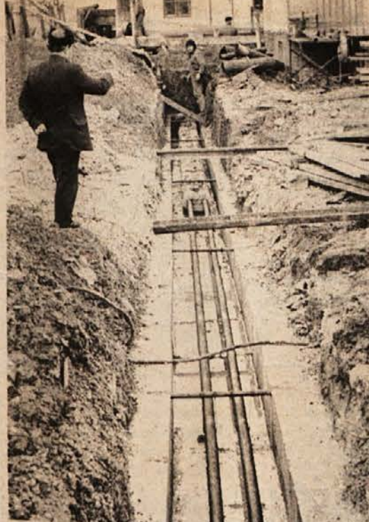
ZA TOPLA STANOVANJA – Ulica 1. maja v Metliki je te dni vsa prekopana. Delavci polagajo cevi za centralno ogrevanje za novo stolpnico. Kurilnica za obe najvišji metliški stolpnici bo skupna. Ljudje negodujejo, ker morajo sedaj gáziti po blatu, vendar je to bolje, kot biti v mrzlem stanovanju.
