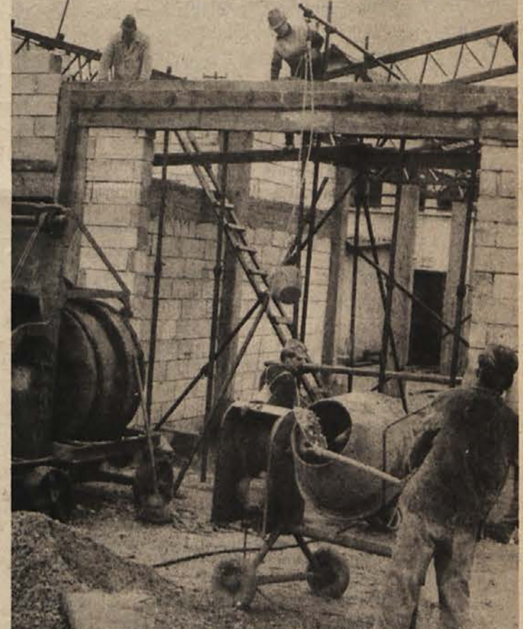
BLIŽE CILJU – Z novimi delovnimi prostori bodo delavci šentlovrenškega Hrasta prvič dobili prostore, prirejene za svoje delo. Na sliki: delavci Tregrada med gradnjo. Stavba je sedaj že pod streho. (Foto: Železnik)
