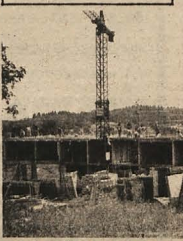
SEMIČ SE ŠIRI – V Semiču rasteta dva nova bloka; v enem bodo solidarnostna stanovanja, v drugega pa se bodo vselili Iskrini delavci. V enem bloku bo dobila prostor tudi podružnica Ljubljanske banke. Računajo, da bosta bloka vseljiva proti koncu leta.
