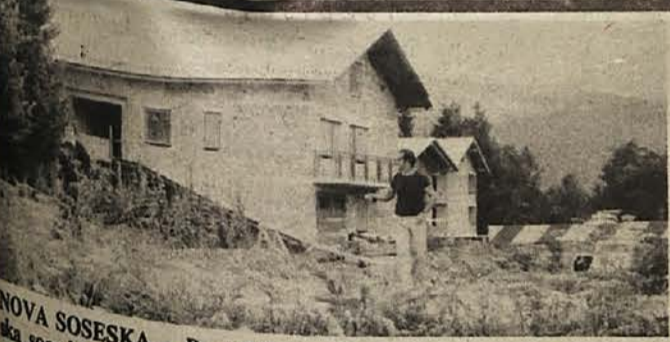
NOVA SOSESKA – Pred Ribnico, na Bregu, raste nova stanovanj- več zasebnikov in prve hiše so že pod streho. Na sliki: začetek nove soeske.
