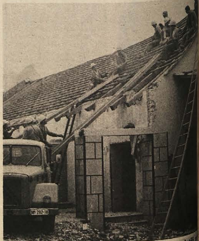
UDARNIŠKO ZA NOVA SKLADIŠČA – V Beti so se lotili ureditve skladišč, zadnjih ostankov konjušnic, ki so jih „podelili“ od vojske. Delajo tudi udarniško in pravijo, da bo čez mesec tu stala nova montažna dvorana, v kateri bo veliko prostora.
