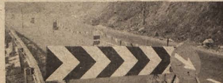
POŠKODOVANA CESTA – Na cesti Kočevje-Brod na Kolpi-Delnice je nova asfaltna cesta na več krajih poškodovana.
