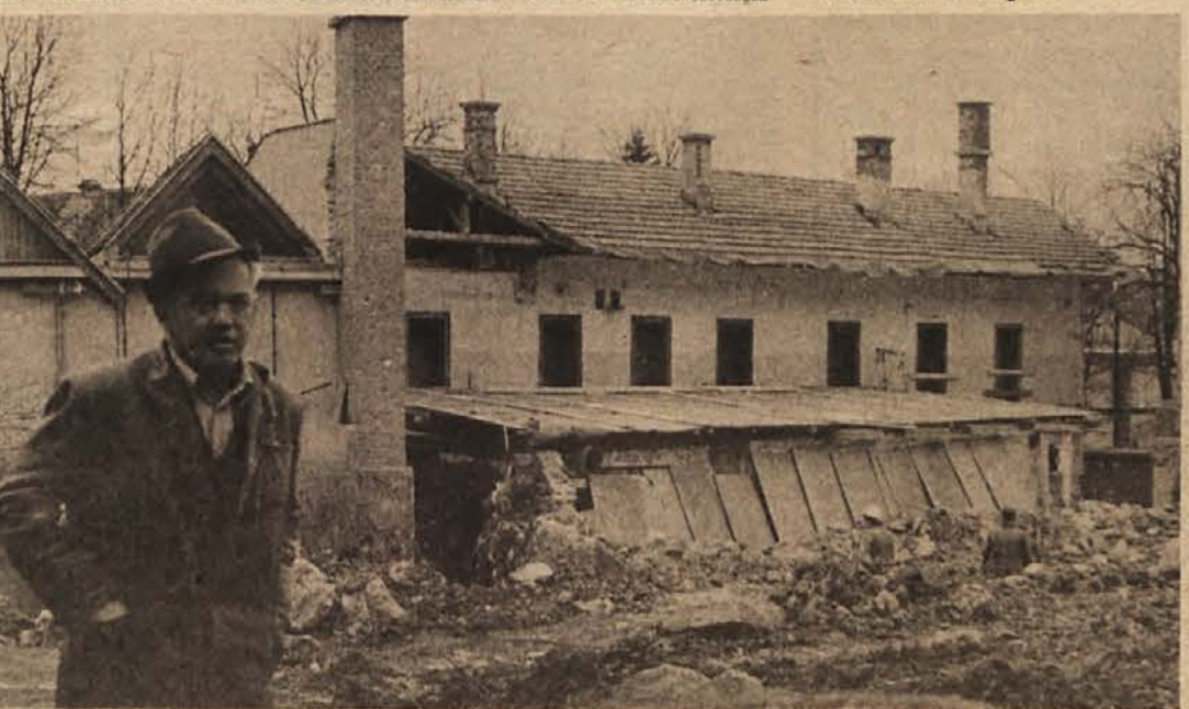
NA GRADBIŠČU VSE ŽIVO! Za novomeško kavarno pri avtobusni postaji je zadnje tedne nastalo veliko gradbišče. Tu bo stal moderen novomeški hotel podjetja „Gorjanci“. Tak turistični objekt v mestu že dlje časa potrebujemo, saj vsakega malo zahtevnejšega gosta napotimo na Otočec. Zatrjujejo, da bo novi hotel s 100 posteljami odprt, še preden se bo pisalo leto 1978. (Foto: R. Bačar)
