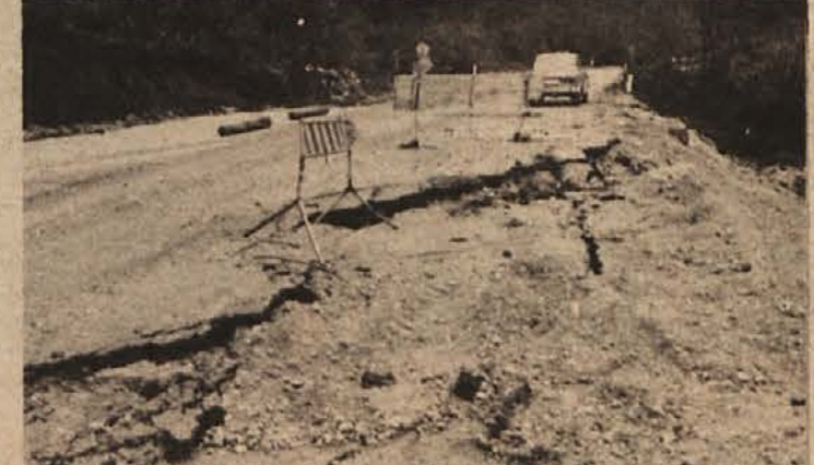
CESTA SE POSEDA - Magistralna cesta Kočevje-Brod na Kolpi, ki je bila odprta pred letom dni, se poseda na krajšem odseku pri bivšem tunelu nad Vas-Faro. Ker je ta del ceste komaj še prevozen, že urejajo novo traso (na fotografiji je vidna zgoraj levo), ki je pomaknjena bolj v hrib. (Foto: Primc)
