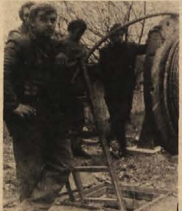
BOLJŠE TELEFONSKE ZVEZE. Delavci PTT podjetja polagajo ob cesti proti železniški postaji v Brežicah nov telefonski kabel, ki bo vodil tja do Globokega. (Foto: J. Teppey)
