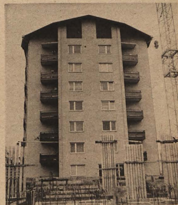
TGP Metlika je zgradilo celo vrsto stanovanjskih objektov. Na sliki: stanovanjski stolpič, ki je že vseljen, pred njim pa raste iz temeljev drug, prav tako velik objekt.
