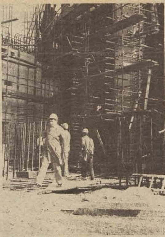
BREZ NAPAKE. V Krškem so minuli petek in soboto preizkušali zaščitni plašč reaktorskega hrana jedrske elektrarne. Pod pritiskom so ga napolnili z zrakom in vzdržal je dve toni obremenitve na kvadratni centimeter. Ugotovili so, da so vsa mesta brezhibno zvarjena. (Foto: V. Podgoršek)
