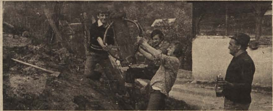
UTRJUJEJO TUDI S PILOTI — Da bo od Marofa do Trnovca lahko bolj brez skrbi vozil avtobus, morajo marsikje breg utrditi tudi s piloti. V akciji so Slavko Pajk, Drago in Ivan Jazbec, tajnik gradbenega odbora Gumzej pa skrbi, tudi, da ne trpijo žeje. (Foto: A. Senica)
