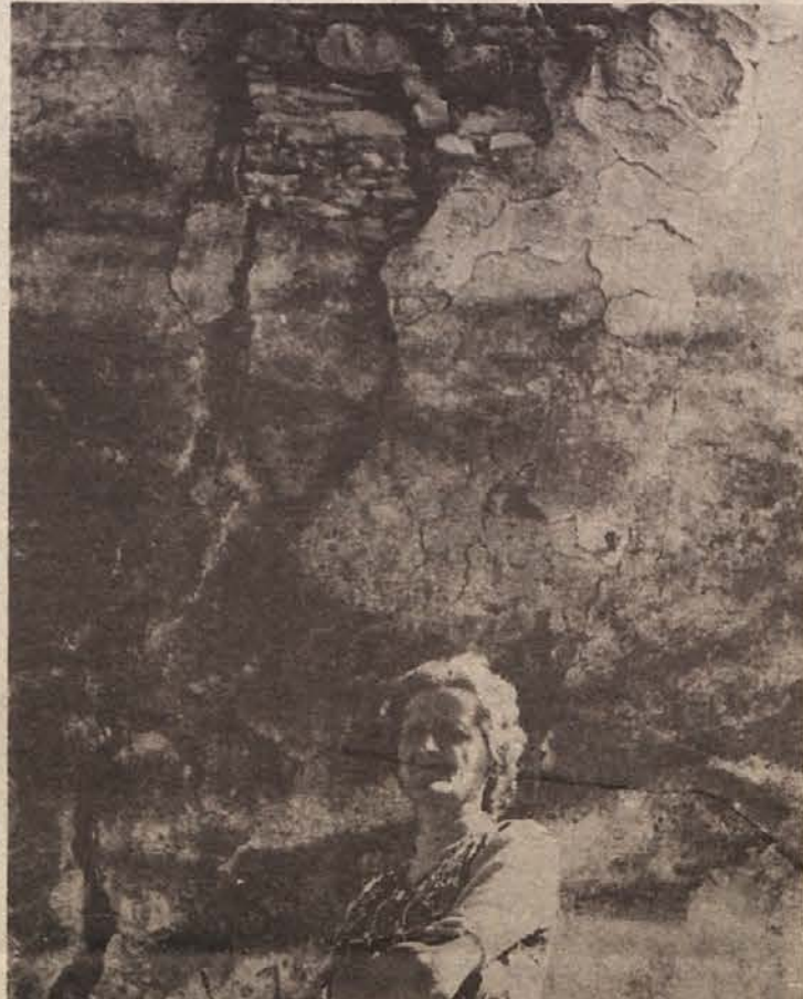
DOMAČIJO BO TREBA ZAPUSTITI – Malči Suhadolnik iz Gorenje vasi pri Šmarjeti pred hišo, ki jo je načel zob stoletij, njegovo delo pa dokončal potres. (Foto: M. Bauer)
