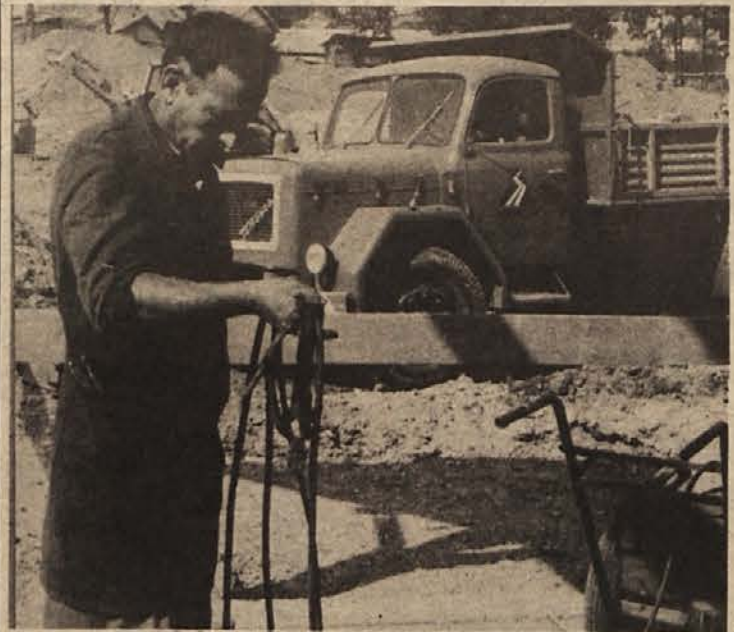
PRIPRAVE NA PREVZEM - V mirenski Kolinski, tozđ Tovarna za predelavo krompirja, se resno pripravljajo na novo sezono. Tu in tam je treba kaj postoriti na razkladalni rampi (na sliki), delavci novomeškega Cestnega podjetja pa že betonirajo temelje novega skladišča. (Foto: Železnik)
