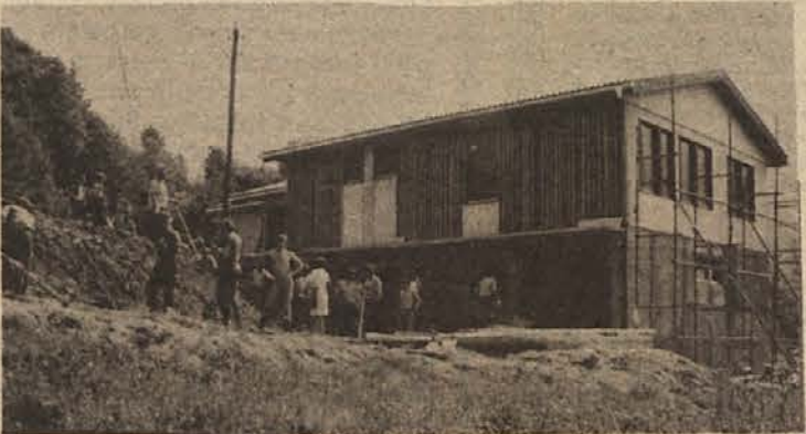
Zdravstveni dom v Oslinici že stoji. Do jeseni, ko bo odprt, pa bo potrebnega še veliko dela. Domačini urejajo okolico, Gramiz ZKGP opravlja razna dela (fasada, dimniki, tlaki, omet itd.), ekipa Marlesa pa dokončuje montažna dela. (Foto: Rugole)
