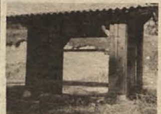
Avtobusna čakalnica v Podpoljanah je popolnoma uničena. Kdo je to storil, bi radi vedeli potniki. (Foto: M. Glavonjic)
