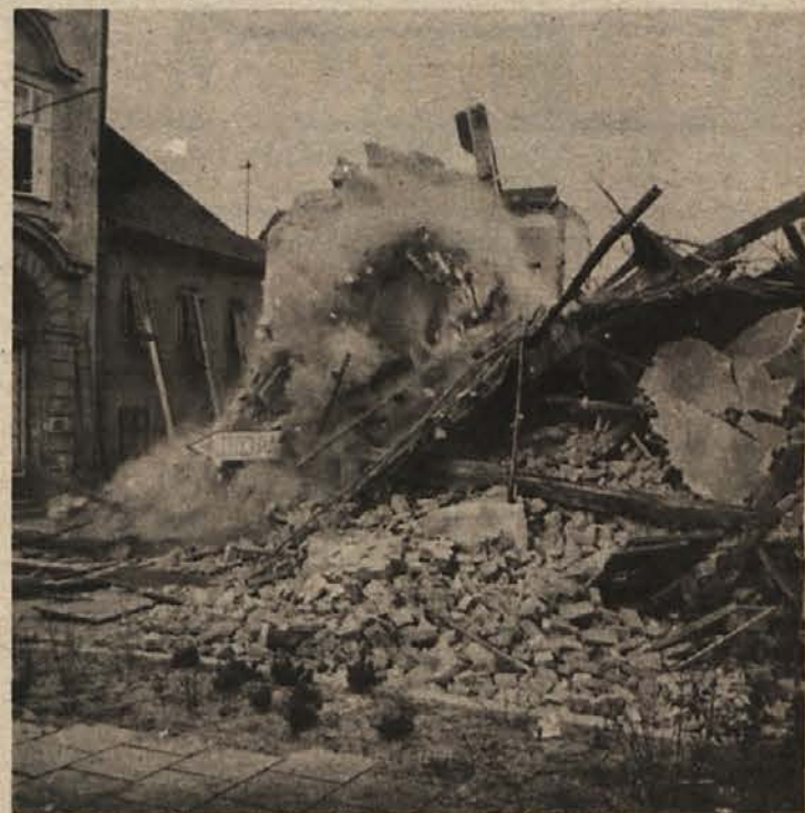
Minuli teden so v Dolenjskih Toplicah razstrelili Sitarjevo hišo. Zahtevno delo so opravili strokovnjaki Geološkega zavoda Ljubljana, delavci podjetja „Vektor“ pa so odstranili ruševine v rekordnih dveh dneh. Na mestu, kjer je bilo poslopje, bodo uredili park. (Foto: S. Mikulan)
