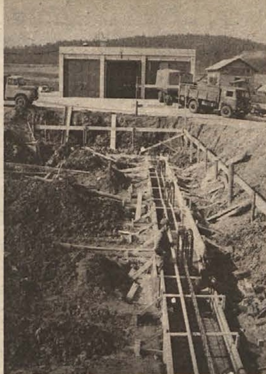
Pri objektu za tehnične preglede v Ločni gradi SGP Pionir, temeljna OZD MKO velik avtoservisni center, v katerem bo mogoče hkrati popravljati do 50 osebnih avtomobilov. To bo prvi sodoben tovrsten objekt na Dolenjskem. (Foto: M. Vesel)
